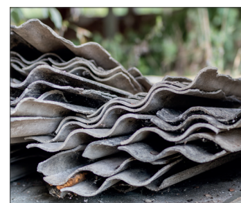
Les plaques de fibrociment ou autre composant contenant de l'amiante.
