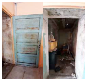
Derrière cette porte, une cave inutilisable pour cause d'humidité
