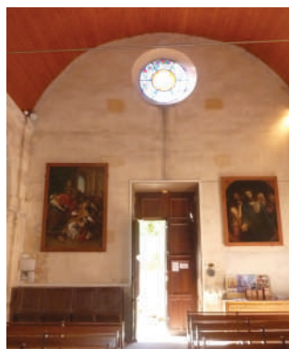
Mur à restaurer
